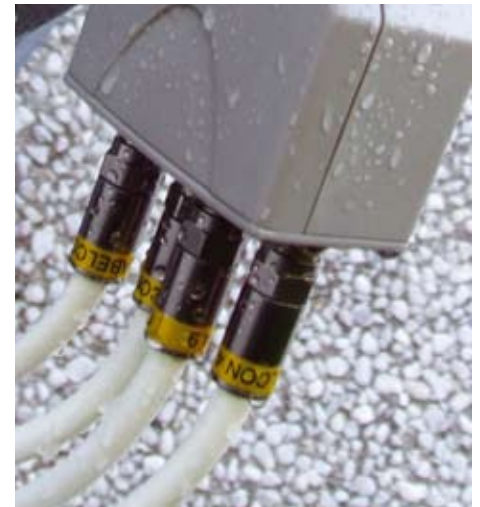
Connecteurs à compression CX3 installés sans besson d'étanchéité supplémentaire.
