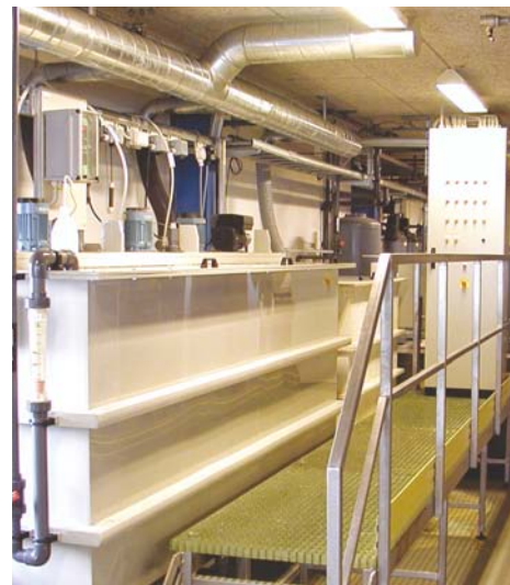
Système de traitement des eaux
