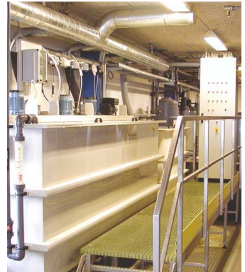
Teil der Abwasseraufbereitungsanlage
